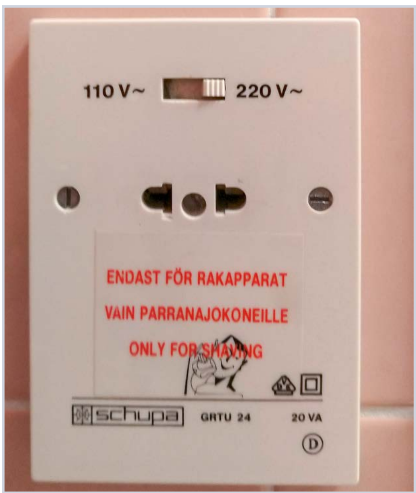
Der Hinweis auf den sachgerechten Gebrauch der Steckdose ist immer noch in schwedischer und finnischer Sprache.
